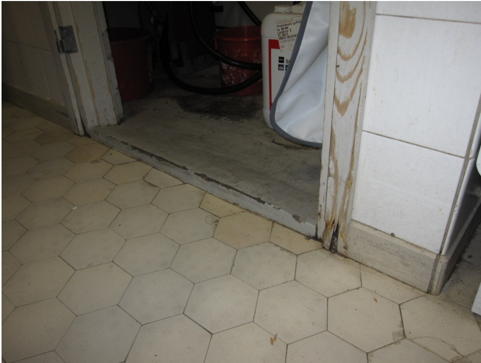
Kuva 11: Keittiön pintarakenteet ja puuosat ovat huonokuntoiset
