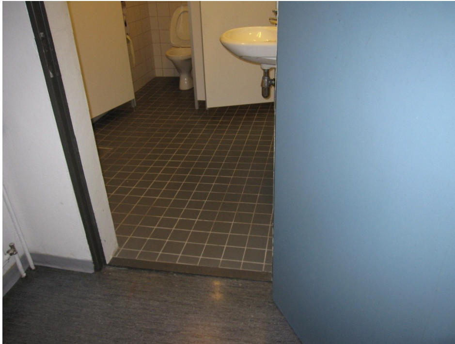
Kuva 13: Toinen WC-tila, jossa kohonneita kosteusarvoja
