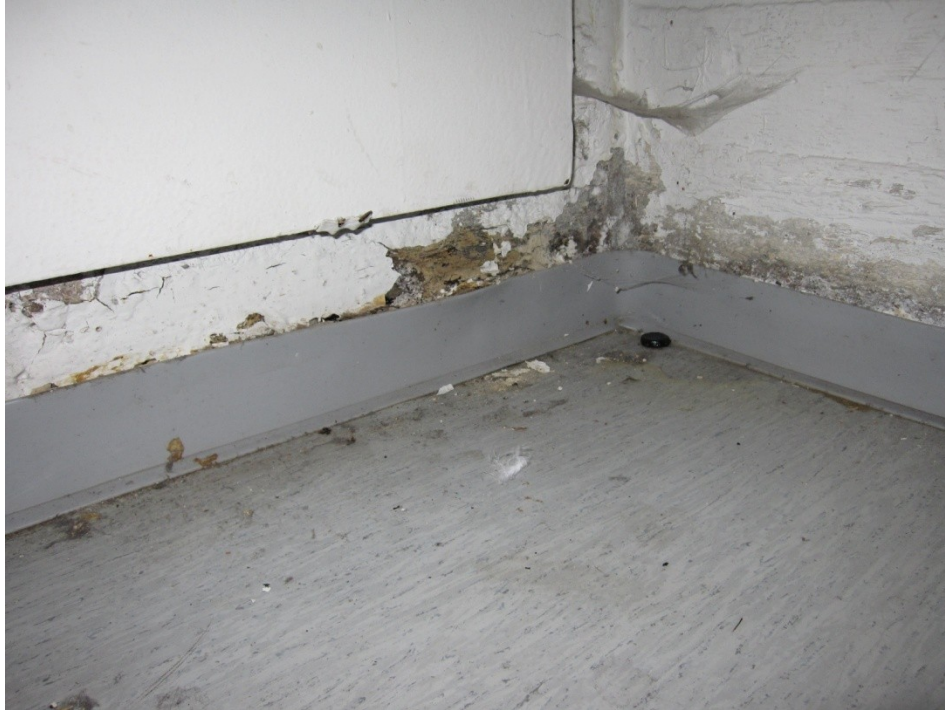
Kuva 10: Kellarikäytävän seinän alaosa
