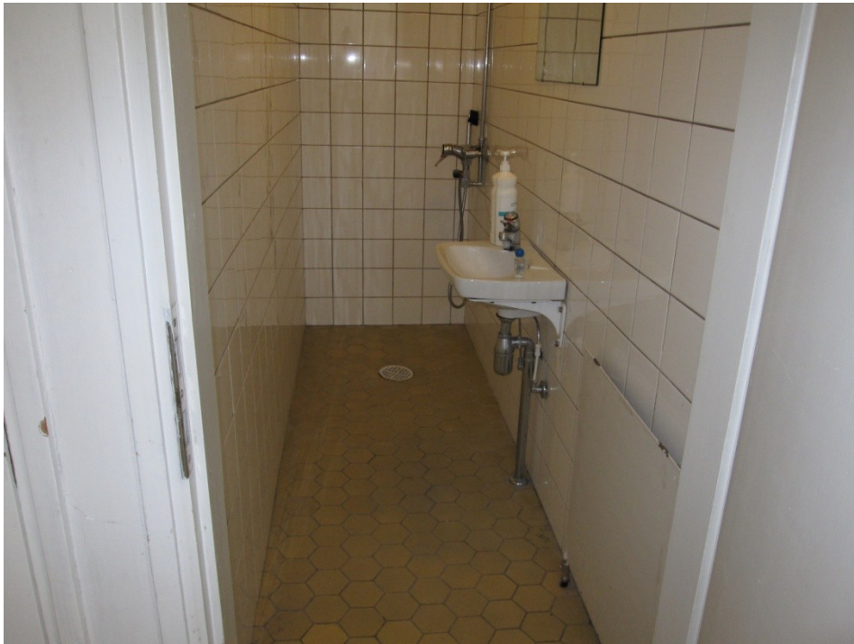
Kuva 14: Kohonneita kosteusarvoja vanhassa märkätilassa
