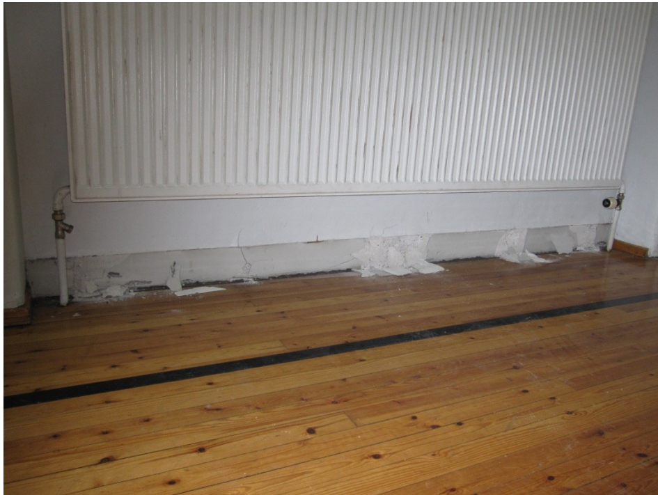
Kuva 1: Seinäpintojen irtoilua liikuntasalissa
