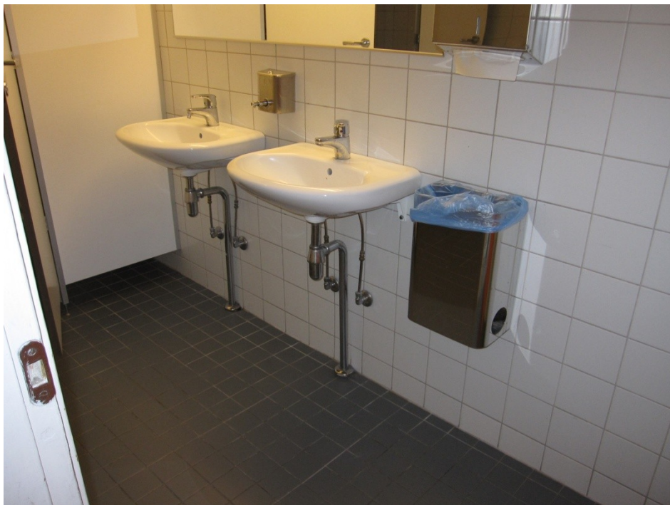
Kuva 15: Kohonneita kosteusarvoja uusitussa märkätilassa
