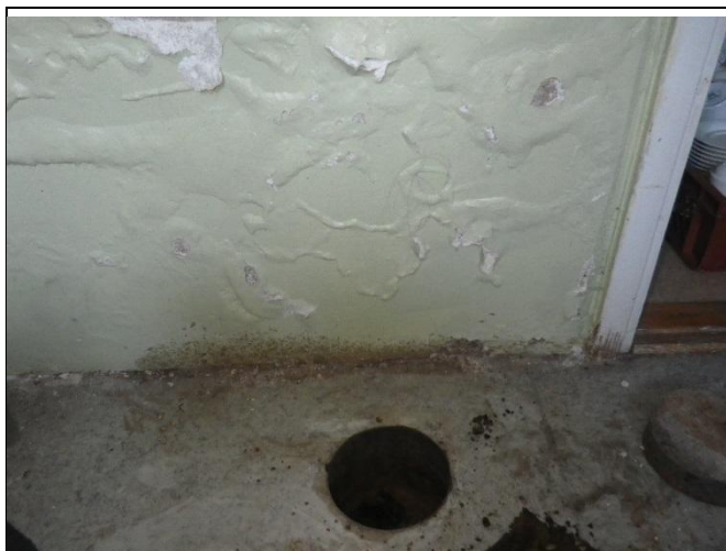
Kuva 6.1 Vaurioita seinän alaosaan.
