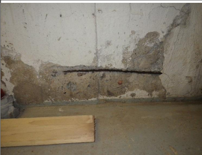
Kuva 11.1 Seinän alaosan betoniteräsvaurio.
