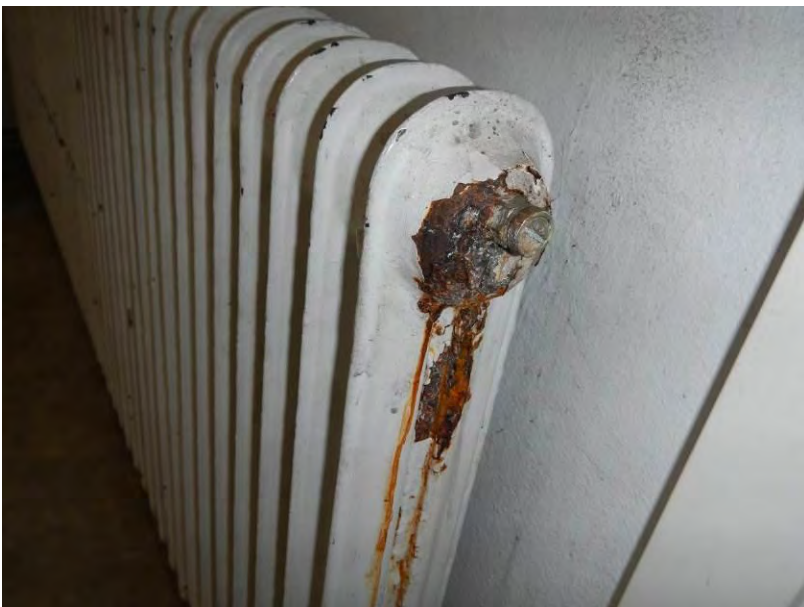
Kuva 3. Pattereiden ilmausruuveissa on vuotojälkiä.
