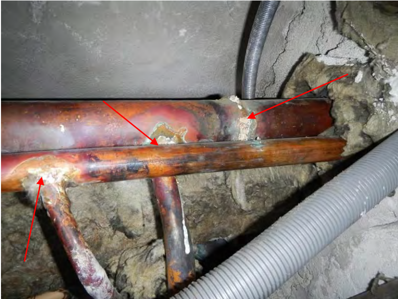
Kuva 5. Messinkijuotoksissa oli havaittavissa sinkinkatoa.
