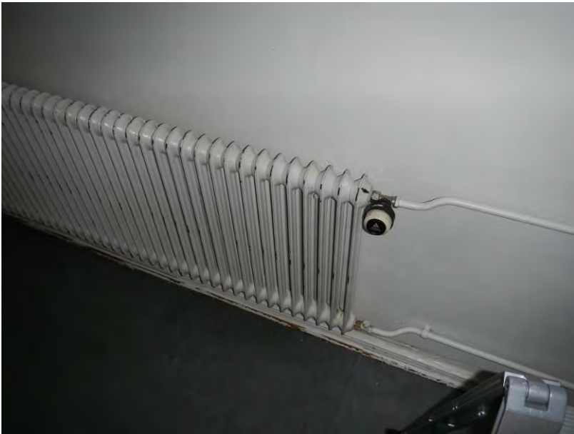
Kuva 2. Yleiskuva vanhasta patteriventtiilistä.
