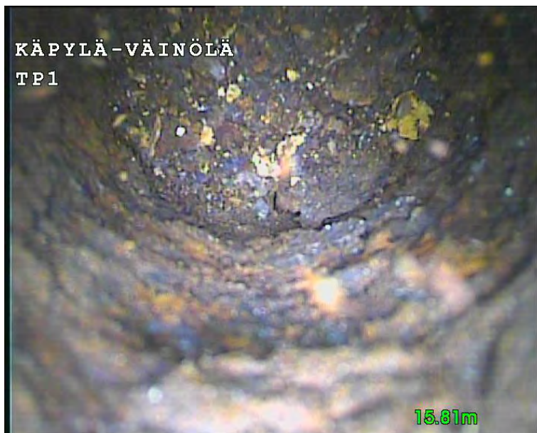
Kuva 7. Viemäri on tukossa.
