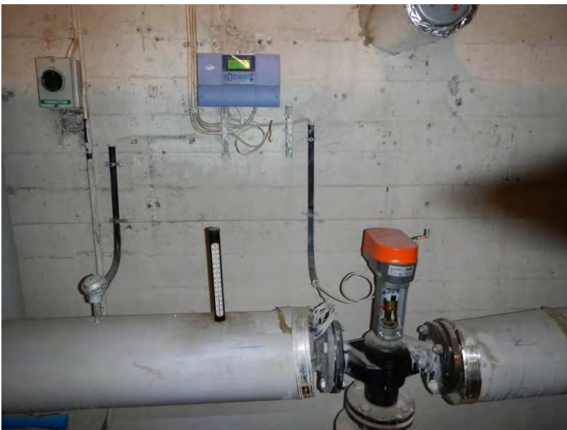
Kuva 1. Yleiskuva shunttiryhmän laitteista.
