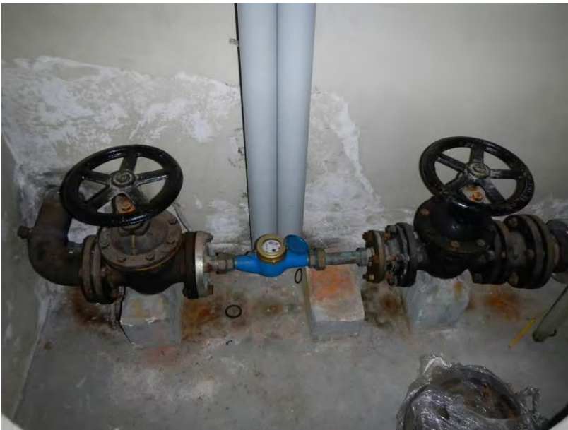
Kuva 4. Yleiskuva vesimittarista ja pääsuluista.
