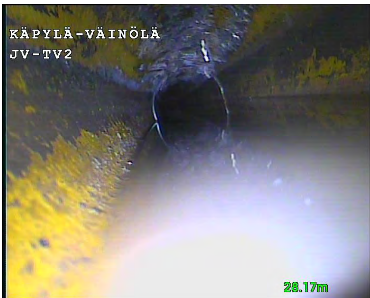
Kuva 6. Viemäriin pohjalla on vettä.
