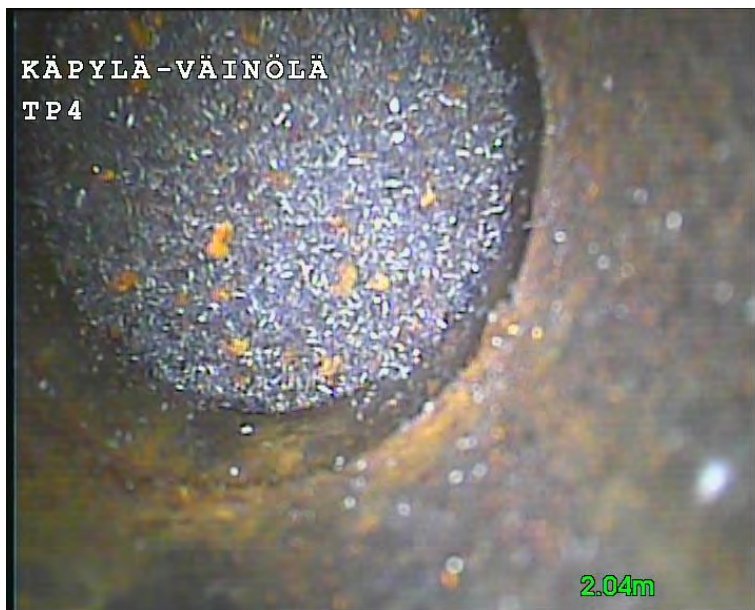
Kuva 9. Viemäri on tukossa.
